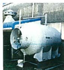
工場の 雨水タンク
